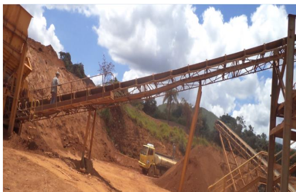
Antes – TR01 sem passarela e estrutura danificada.
