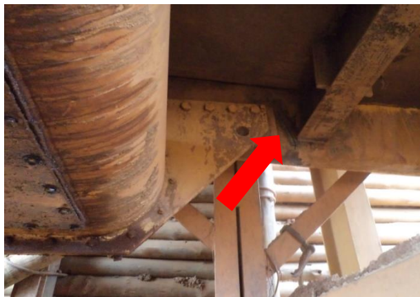
Antes – Trincas na estrutura base do AL.
