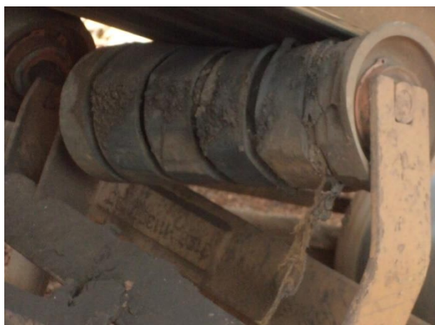
Antes – Roletes travados e desgastados
